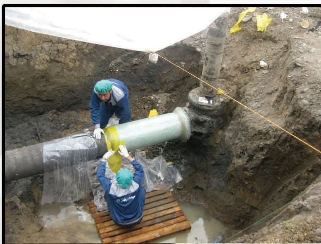
تعمیر نواحی خورده شده بر روی لوله ۲۰ اینچ خطوط انتقال گاز منطقه ۹ ( بهار ۹۷ )
